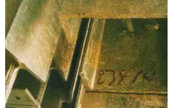
Fig. 4: Defecto por haber realizado marcas con pinturas que no se han eliminado previamente
