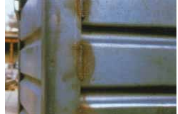
Fig. 2: Residuos de grasa quemados alrededor de una soldadura de un contenedor (antes de la galvanización) pueden producir defectos en el recubrimiento
