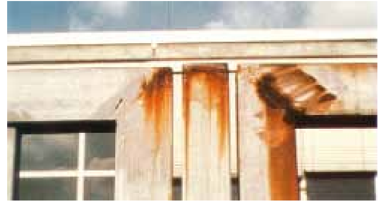
Fig. 4. Corrosión causada por una restauración incorrecta del recubrimiento en una unión soldada.
