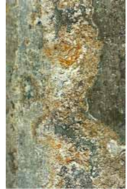
Fig. 4: Manchas blancas profundas con pérdida de una gran parte del espesor del recubrimiento de zinc. Pueden apreciarse incluso corrosiones locales del acero base.
