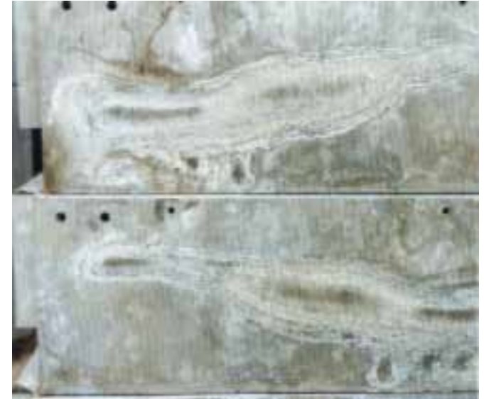
Fig.1: Aspecto de unos recipientes galvanizados para agua después de varios meses de almacenamiento a la intemperie. El apilamiento de unos sobre otros, con sus superficies planas en contacto, impidió la libre circulación del aire entre las mismas, con el resultado de formación de manchas blancas.
